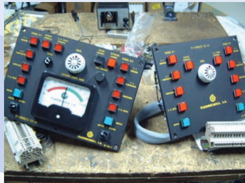
Панель аварийной сигнализации для управления из ходовой рубки и машинного отделения.
